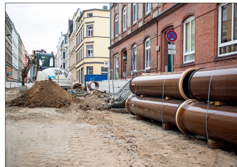
Bereits im vergangenen Sommer wurde in der Wittenburger Straße gebaut Foto: maxpress/gh
