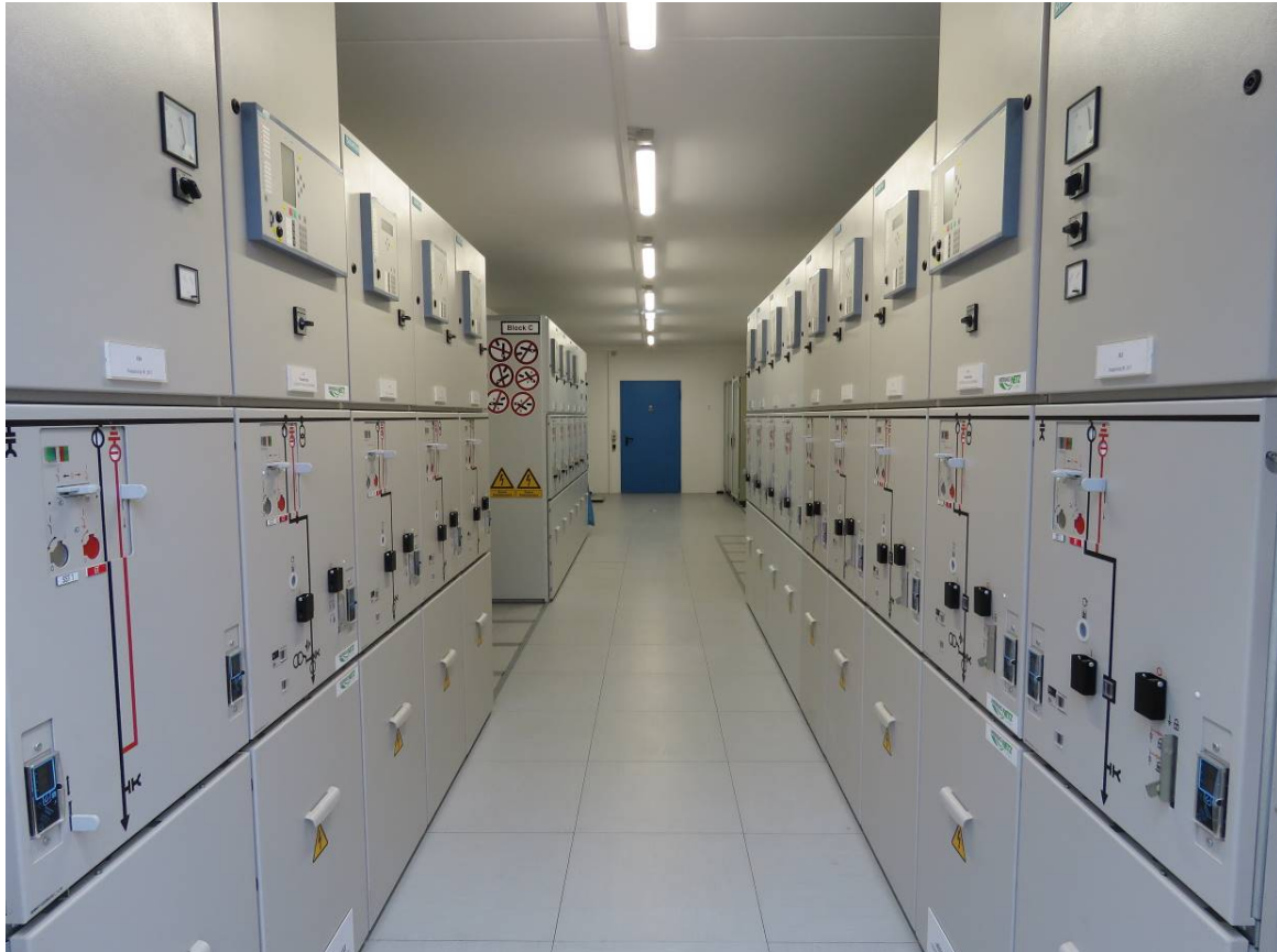
BU: Hochmoderne Technik sorgt im Inneren der modernen Mittelspannungsschaltanlage für eine sichere Stromversorgung
