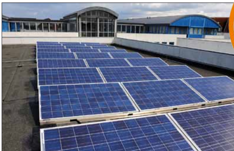
Auch auf dem Dach des Verwaltungsgebüdes der Stadtwerke Schwerin befindet sich eine Photovoltaikanlage Foto: maxpress/jk
