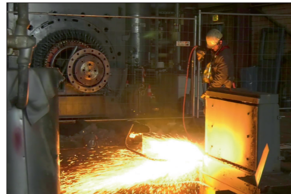
Ein Spezialunternehmen führt die Demontearbeiten am HKW Süd durch. Sie sollen Ende Oktober abgeschlossen sein
