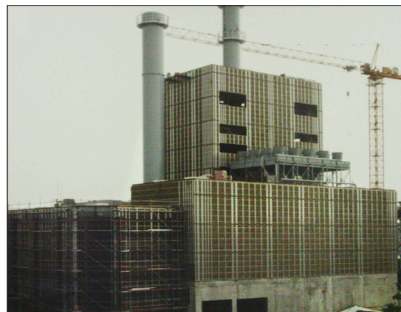
Abbildung aus dem Jahr 1993 während der Bauzeit des Heizkraftwerkes in Lankow Fotos: SWS
